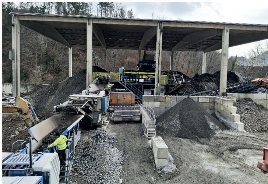
Slika 4: Tehnološka oprema - postavitev za predelavo metalurških odpadkov
