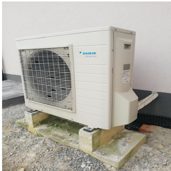
Slika 10: Toplotna črpalka zrak-voda. (Šteinfelser, 2019)
