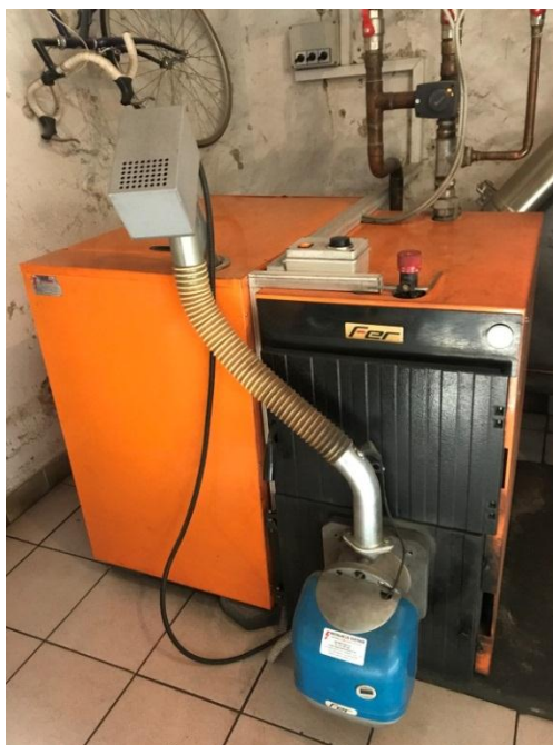
Slika 4: Kotlovnica na pelete. (Ačko, 2018)
