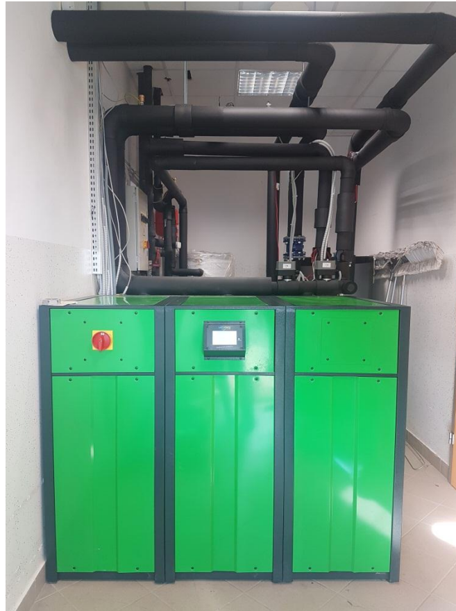
Slika 8: Toplotna črpalka zemlja-voda. (Ačko, 2018)
