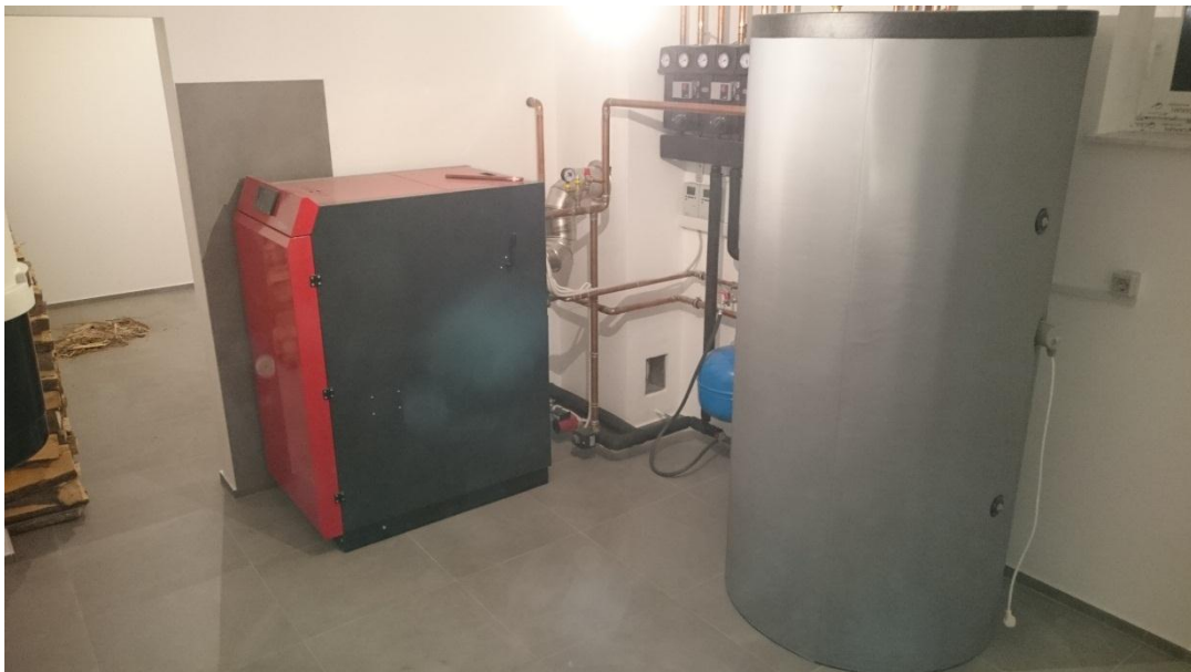
Slika 1: Kotlovnica na polena z zalogovnikom. (Ačko, 2018)
