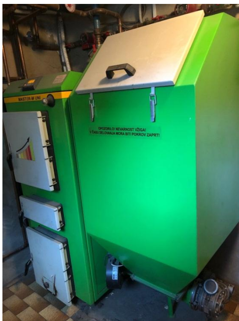
Slika 2: Kotlovnica na sekance. (Ačko, 2018)
