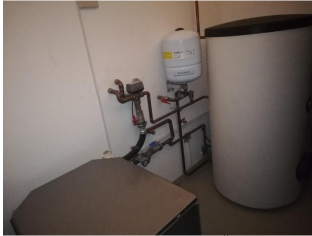
Slika 9: Toplotna črpalka zrak-voda. (Šteinfelser, 2019)
