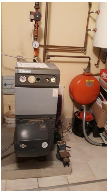
Slika 5: Kotlovnica na kurilno olje. (Ačko, 2018)
